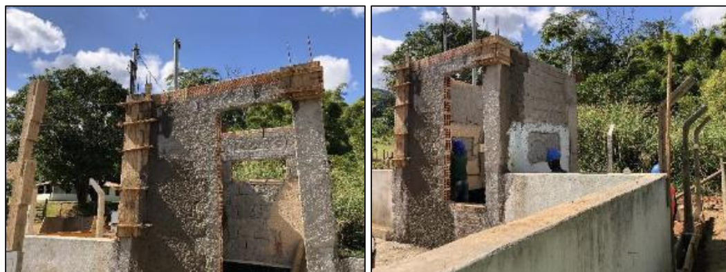
Figura 75: Visão lateral e dos fundos das obras no abrigo elétrico do poço Beira Rio (foto data: 01/06/2023).
