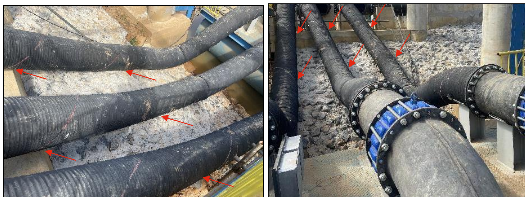
Figura 10: Mangote flexível apoiado sobre quina de concreto e sobre enrocamento de pedras (foto data: 05/06/2023).
