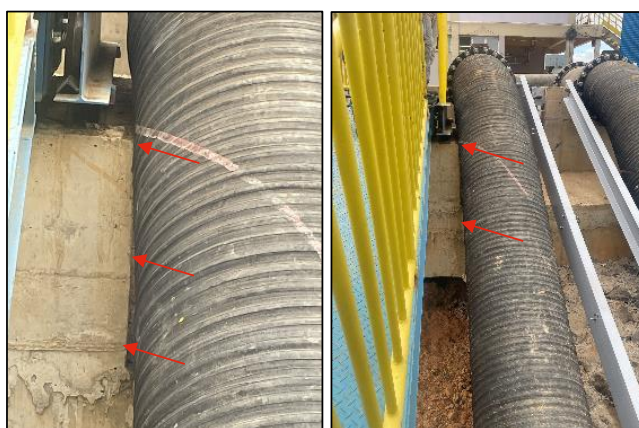
Figura 14: Mangote flexível apoiado sobre quina de concreto (foto data: 06/07/2023).
