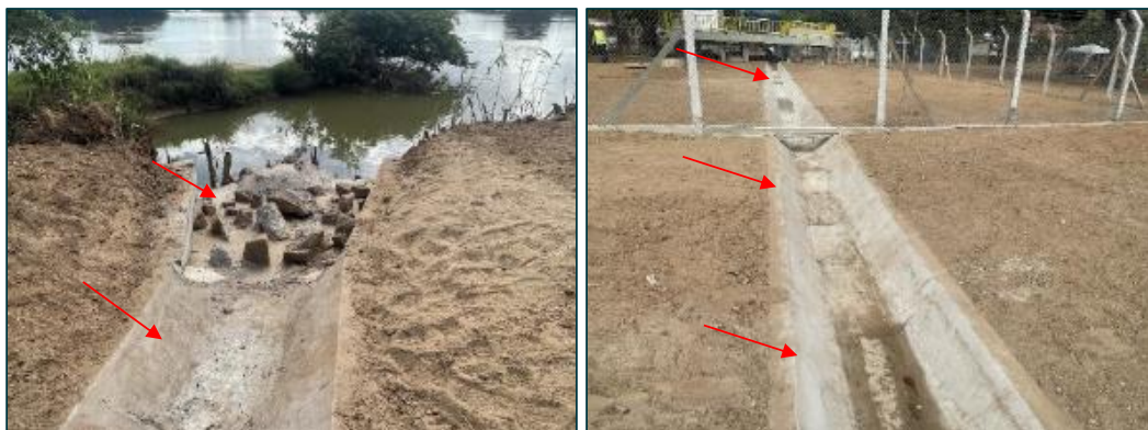
Figura 68: Canaleta de drenagem de água pluvial das portas e janelas das salas técnicas (foto data: 06/06/2023).
