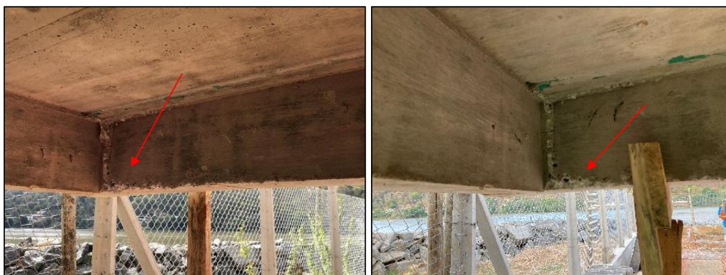
Figura 5: Pontos de segregação do concreto apontados em junho/2023, à esquerda, e sem reparação, à direita (foto data: 05/07/2023).
