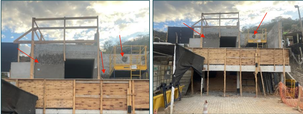
Figura 40: Execução de chapisco, emboço e reboco na alvenaria externa do abrigo do sistema de pré-cloração (foto data: 05/07/2023).
