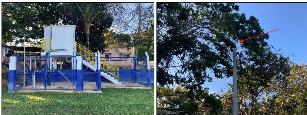
Figura 79: Área do poço tubular profundo, à esquerda, e poste do padrão de energia, à direita (foto data: 05/06/2023).
