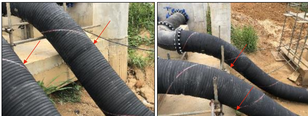
Figura 9: Mangote flexível apoiado sobre quina de concreto (foto data: 09/03/2023).
