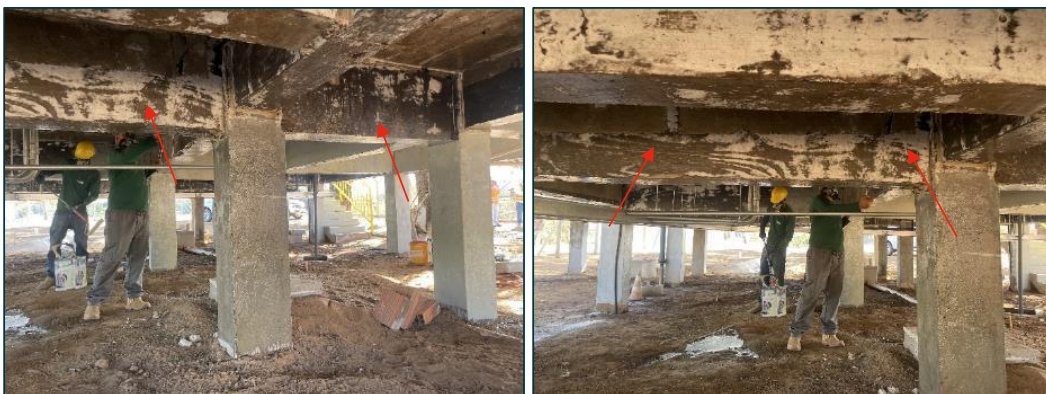
Figura 61: Impermeabilização da estrutura da laje, pilares e vigas da ETA (foto data: 05/07/2023).
