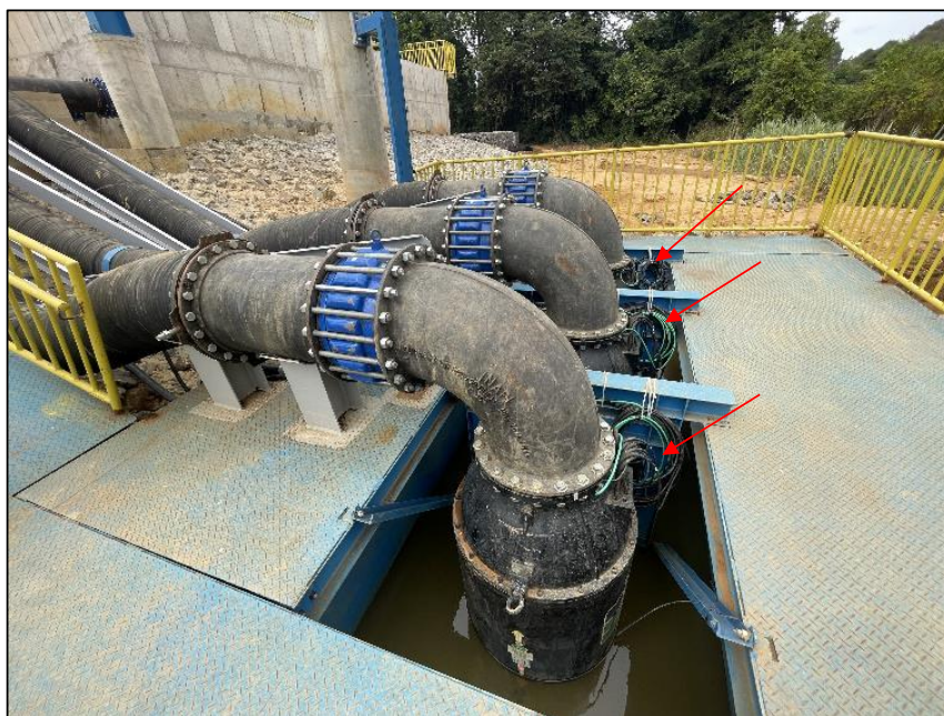
Figura 46: Bombas da captação alternativa energizadas (foto data: 06/07/2023).
