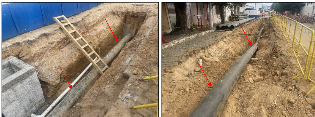
Figura 65: Assentamento da tubulação do Sistema Alternativo de Captação e Adução (foto data: 05/07/2023).
