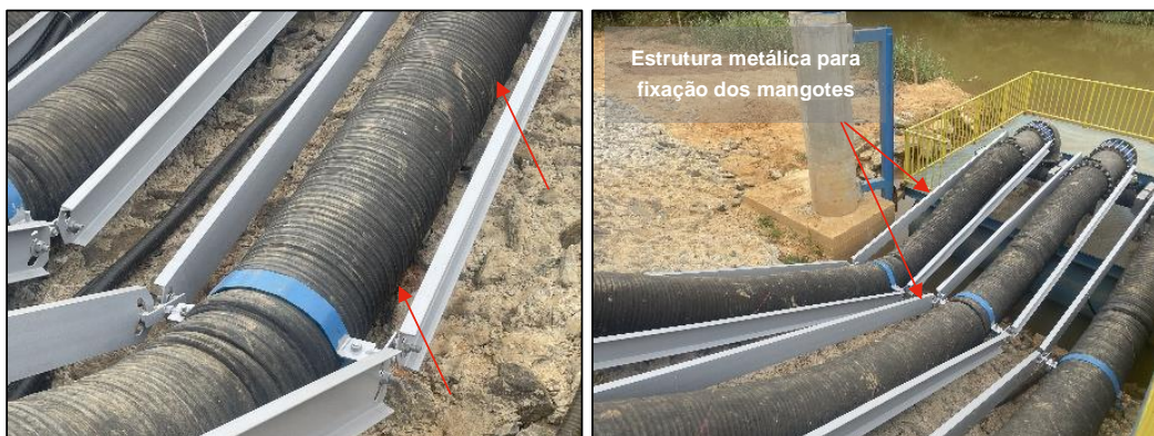
Figura 13: Mangote flexível apoiado sobre o enrocamento de pedras (foto data: 06/07/2023).
