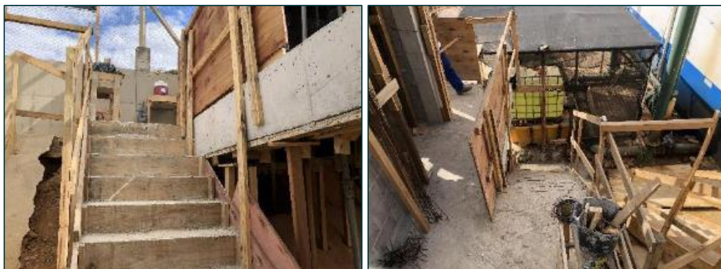
Figura 36: Escada de acesso ao abrigo do sistema de pré-cloração concretada (foto data: 06/06/2023).
