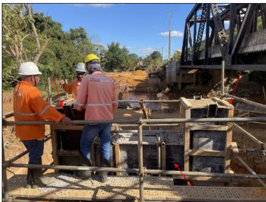
Figura 47: Desforma dos blocos de ancoragem da estrutura do "pipe rack 3" (foto data: 05/06/2023).
