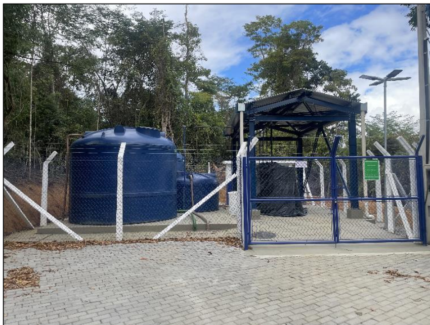
Figura 74: Vista geral da área do Sistema de Tratamento de Água (foto data: 05/07/2023).
