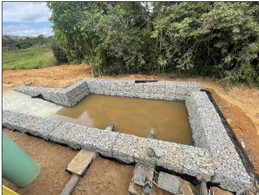
Figura 45: Tanque de sedimentação do desarenador (foto data: 06/07/2023).
