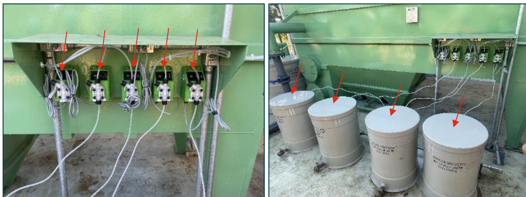
Figura 63: Instalação de infraestrutura dos dosadores de produtos químicos (à esquerda) e tanque com produtos químicos posicionados (à direita) (foto data: 05/07/2023).
