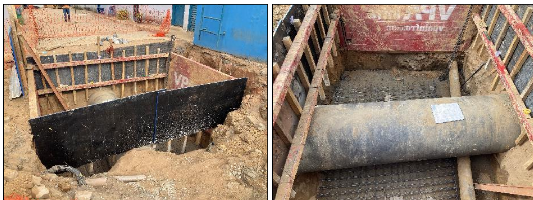
Figura 54 Execução da caixa do medidor de vazão na chegada da ETA Central (foto data: 06/07/2023).
