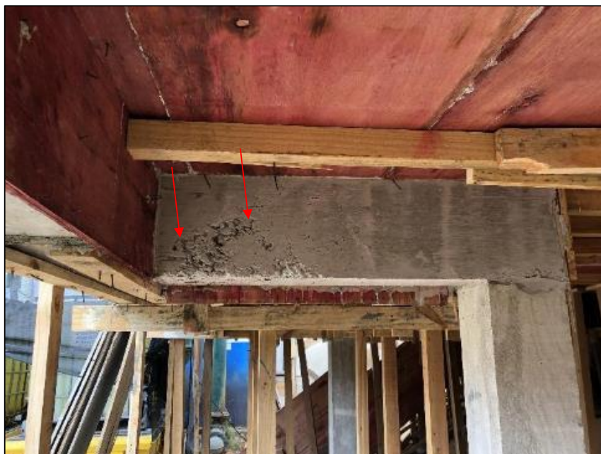
Figura 4: Segregação do concreto em viga (foto data: 06/06/2023).
