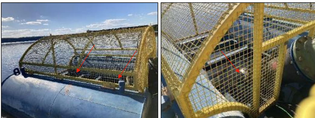
Figura 55: Bomba de 100L/s restabelecida e instalada na balsa de captação (foto data: 05/06/2023).
