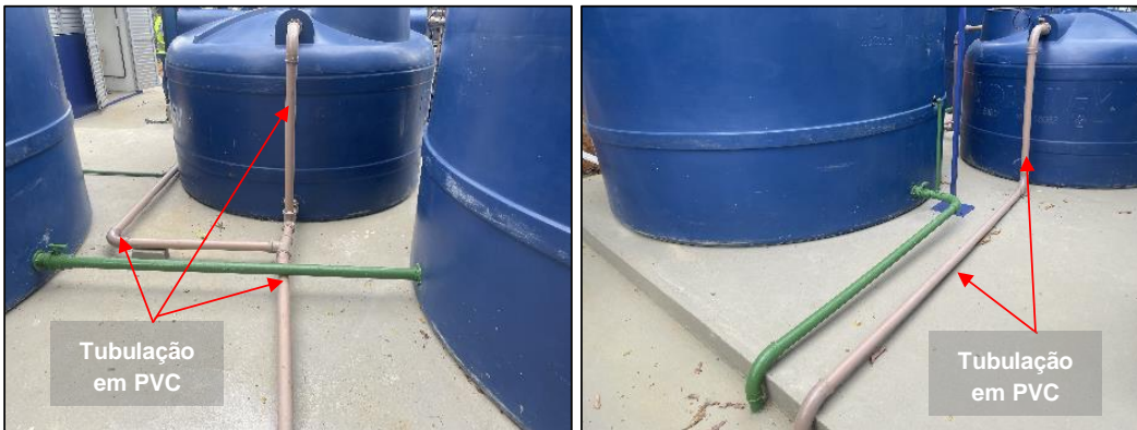
Figura 34: Tubulação em PVC do sistema de tratamento de água exposta a intempéries (foto data: 05/06/2023).
