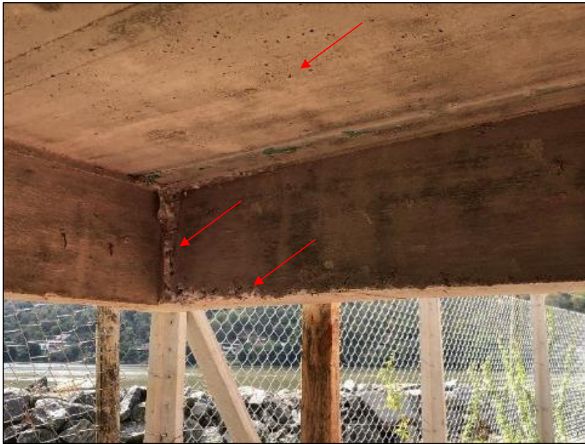
Figura 5: Segregação do concreto em viga e em laje (foto data: 06/06/2023).
