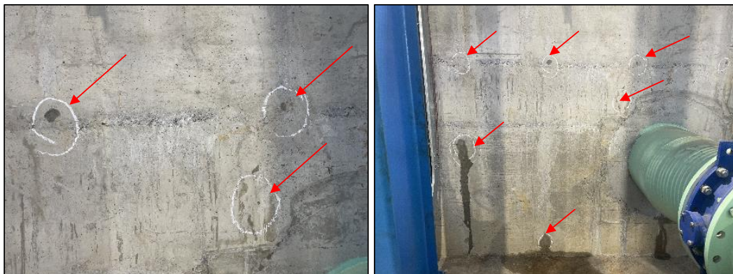
Figura 47: Pontos de merejamento nas estruturas do desarenador e poço de sucção (foto data: 06/07/2023).
