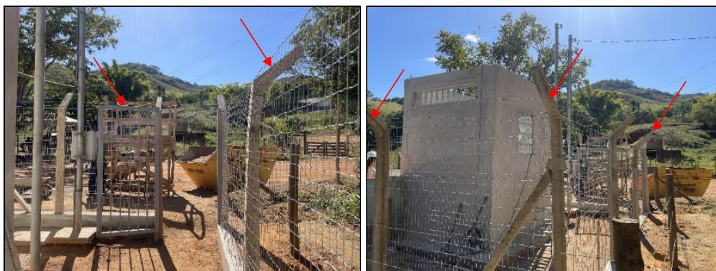
Figura 69: Instalação do cercamento no perímetro da área do poço Beira Rio (foto data: 04/07/2023).
