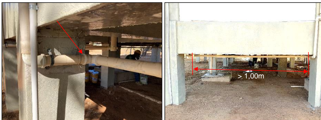
Figura 22: Derivação para ventilação em nível, à esquerda, e distância elevada entre desconector e tubo ventilador, à direita (foto data: 06/07/2023).
