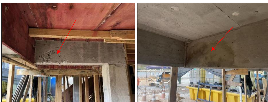
Figura 4: Pontos de segregação do concreto apontados em junho/2023, à esquerda, e após adequações realizadas pela Fundação Renova, à direita (foto data: 05/07/2023).
