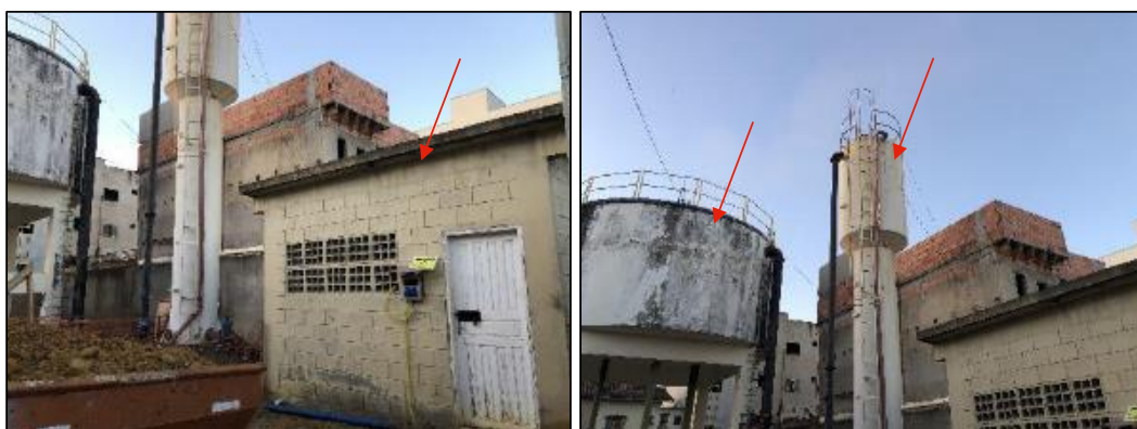
Figura 93: Estação elevatória de água e reservatórios existentes (foto data: 05/06/2023).
