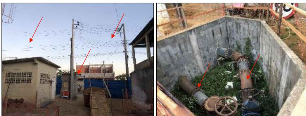
Figura 97: Rede elétrica existente e caixa de manobras (foto data: 05/06/2023).
