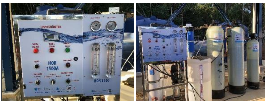
Figura 84: Sistema de tratamento de água (foto data: 05/06/2023).
