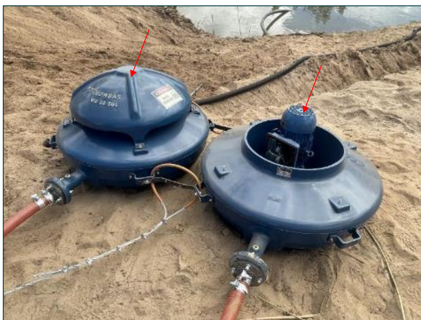
Figura 69: Flutuantes e bombas de captação superficial (foto data: 06/06/2023).
