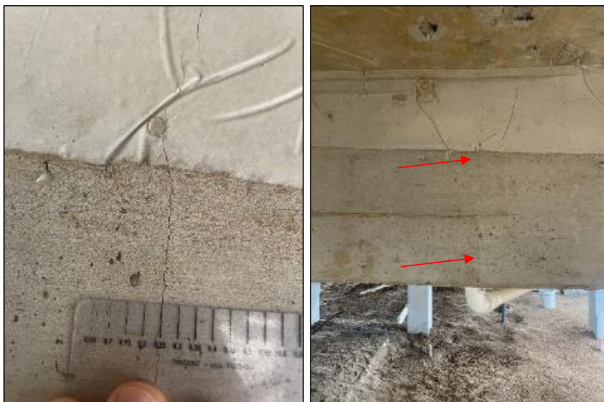
Figura 17: Fissura identificada na viga de concreto da estrutura da nova ETA (foto data: 06/06/2023).
