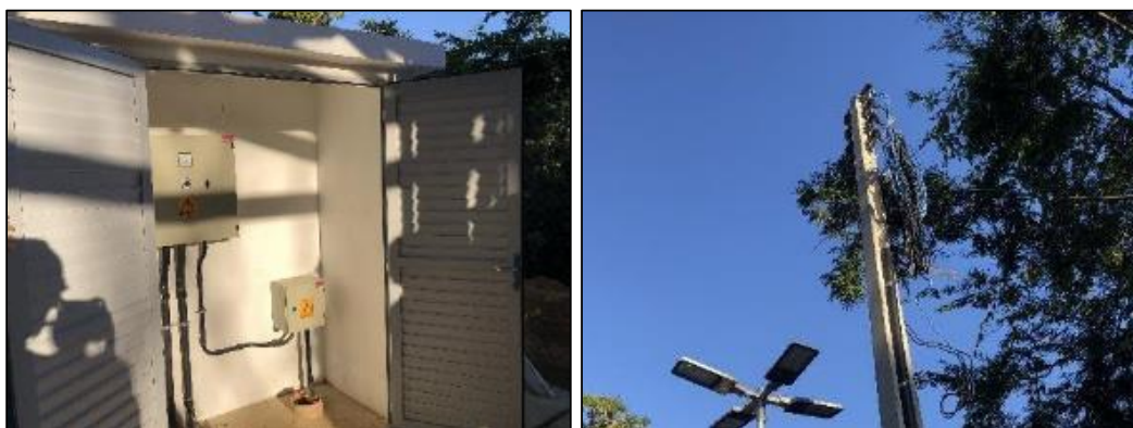
Figura 86: Abrigo, quadros de comando elétrico, à esquerda, e poste do padrão de energia, à direita (foto data: 05/06/2023).
