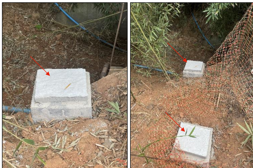
Figura 77: Caixas de passagem do sistema de distribuição próximo à rodovia ES 248 (foto data: 05/07/2023).
