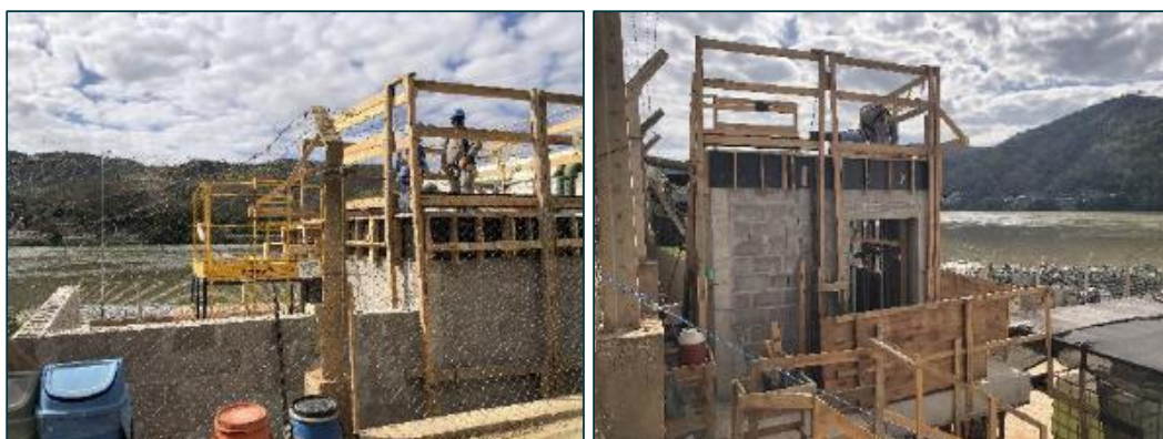
Figura 35: Visão dos fundos do abrigo do sistema de pré-cloração (foto data: 06/06/2023).
