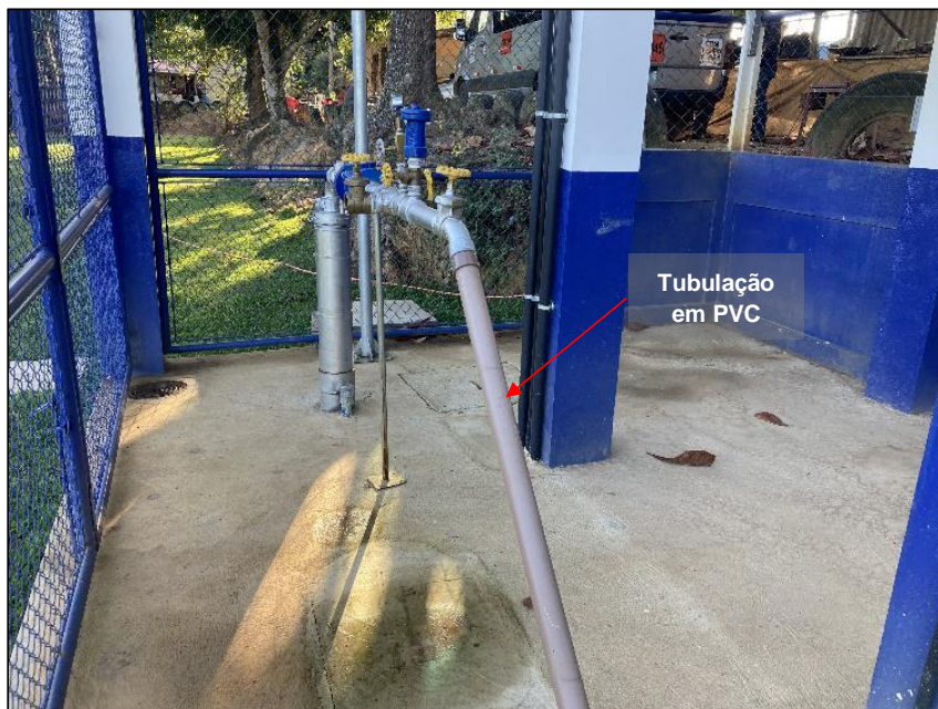
Figura 35: Tubulação em PVC do sistema de tratamento de água exposta a intempéries (foto data: 05/06/2023).
