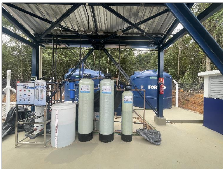
Figura 75: Detalhe das unidades do Sistema de Tratamento de Água (foto data: 05/07/2023).
