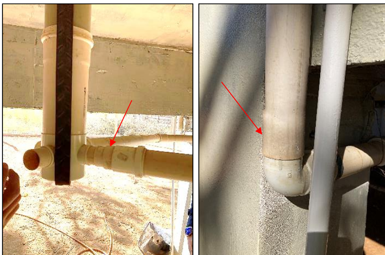
Figura 21: Redução da seção da tubulação, à esquerda, e aumento de diâmetro por meio de aquecimento, à direita (foto data: 06/07/2023).
