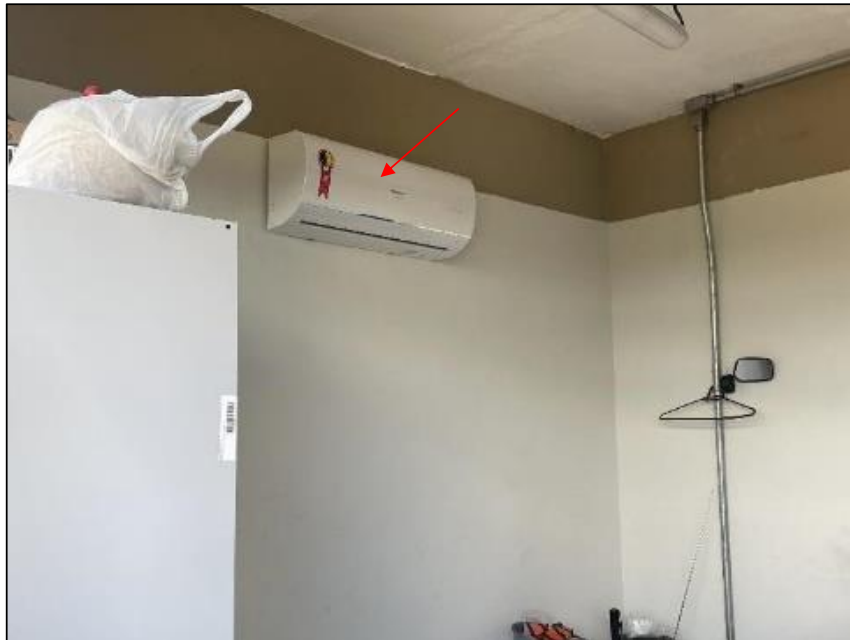
Figura 43: Sistema de climatização nas salas técnicas (foto data: 05/06/2023).
