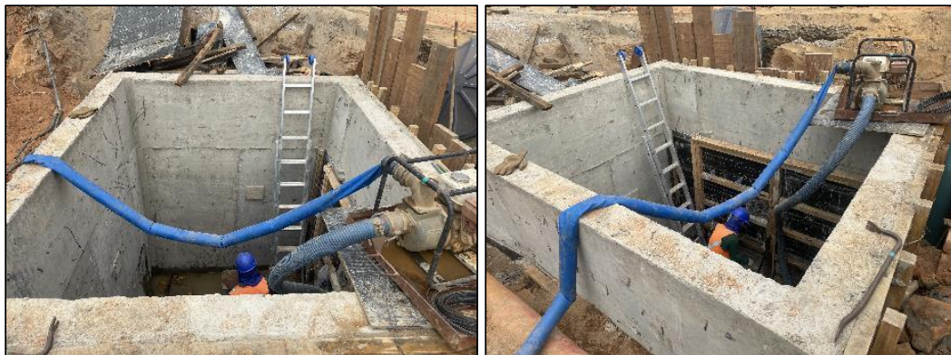
Figura 53: Execução de caixa de descarga na área da ETA Central (foto data: 06/07/2023).
