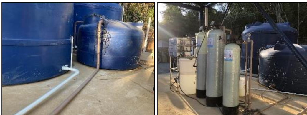
Figura 85: Reservatórios do STA, à esquerda, e sistema de tratamento de água, à direita (foto data: 05/06/2023).
